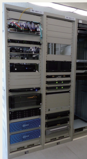
MAMシステムのマスター装置 (ラック室)
