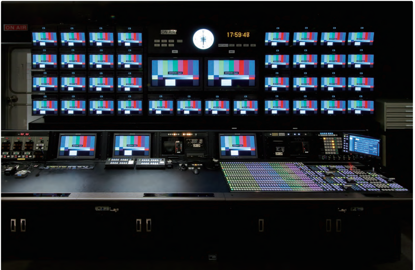
電源の二重化、制御LANの分離などにより安全性が追求されたAスタジオ・サブ
