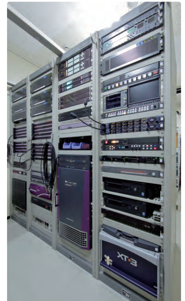
メインフレームが収納されている機器架。アラーム監視サーバーも導入し、障害発生時の迅速な通知機能とログ記録を実現
